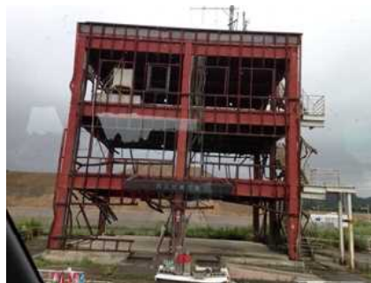
←南三陸町 防災対策庁舎
